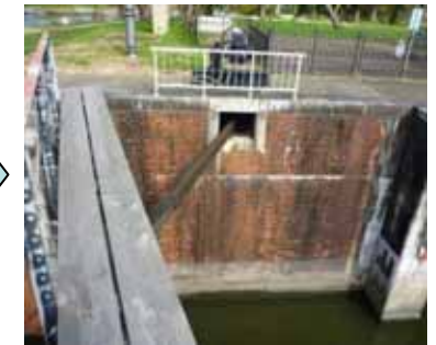
横利根閘門 (T10) 内部手動ラックアーム型
