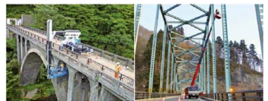
▲橋の老朽化損傷原因の例
