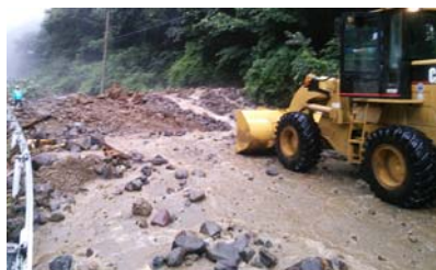
▲土砂崩れにより通行不能となった 国道46号(8月9日 雫石町内)
