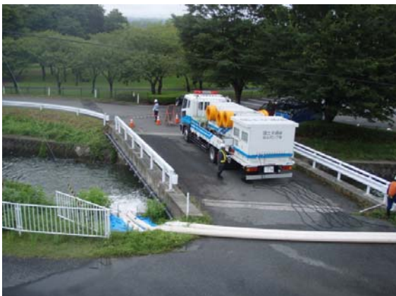
排水ポンプの稼働実演
