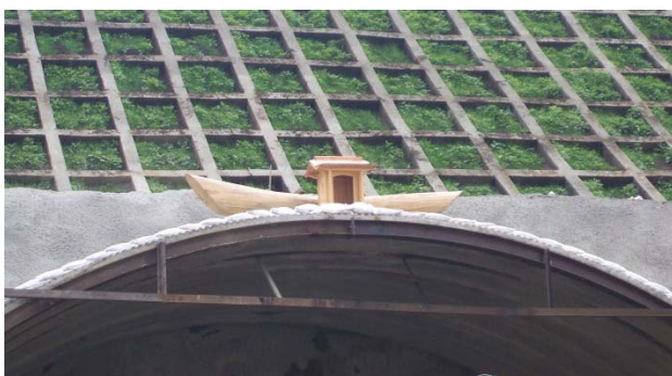
〈トンネル工事の安全を祈願する化粧木と神棚〉
