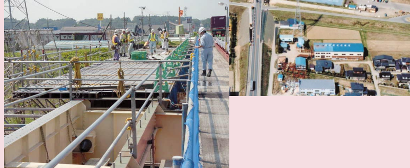
国道4号 北上拡幅の和賀川にかかる「和賀大橋」の幅を拡げる工事
