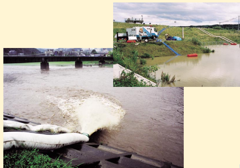
洪水の時、堤防の内側にたまった内水をポンプで川に排水しているところ
