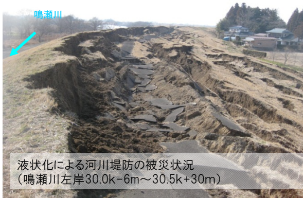
東北地方太平洋沖地震による堤防被災事例
