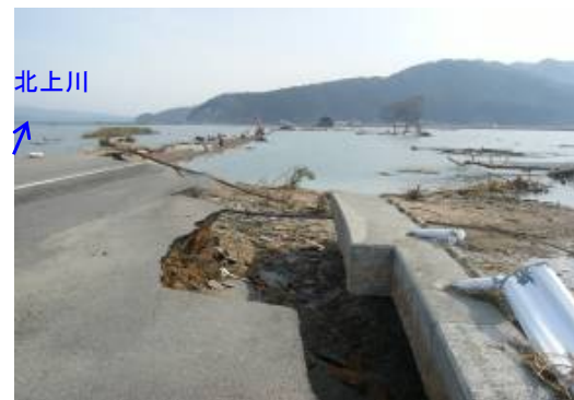
津波による堤防決壊 (北上川右岸4.0k付近 石巻市釜谷地先)
