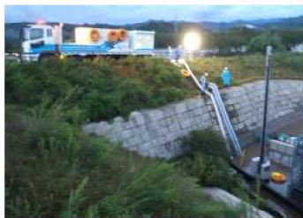
排水ポンプ車稼働状況(宮古市)
