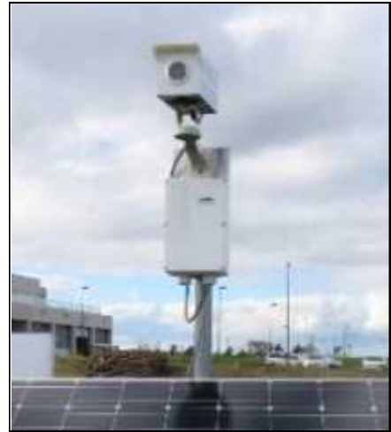
簡易型河川監視カメラ
