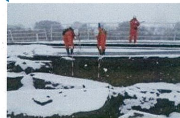
堤防被災状況の把握
