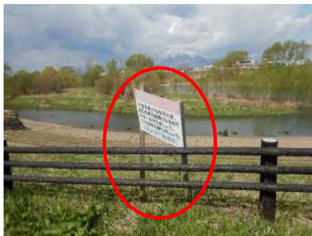
注意喚起看板の破損
