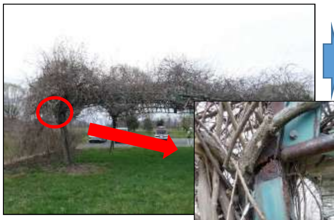
藤棚(支柱)の腐食
