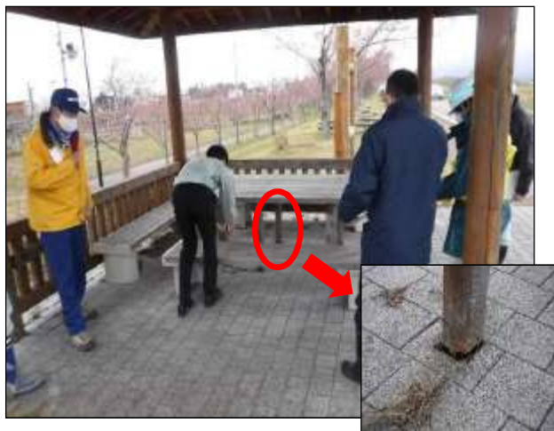
東屋のテーブル脚腐食
