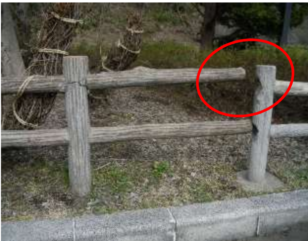
防止柵の破損
