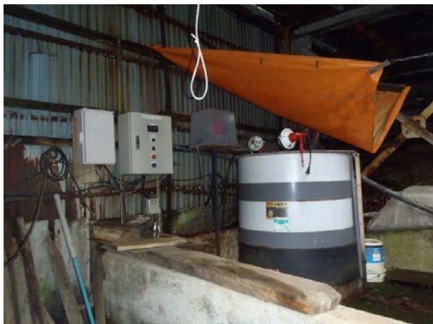
凝集剤タンク、凝集剤投入動力盤
