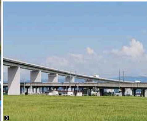
1 桑折高架橋(仮)の橋脚施工状況 2 桑折高架橋(仮) 進捗状況 3 桑折高架橋(仮) 完成イメージ図
