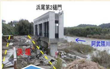
堤防決壊 1箇所 (須賀川市浜尾第二樋門)
