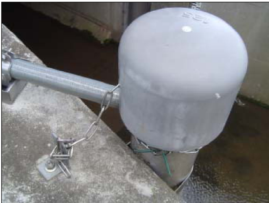
水位計の状況:通常時には蓋がされている
