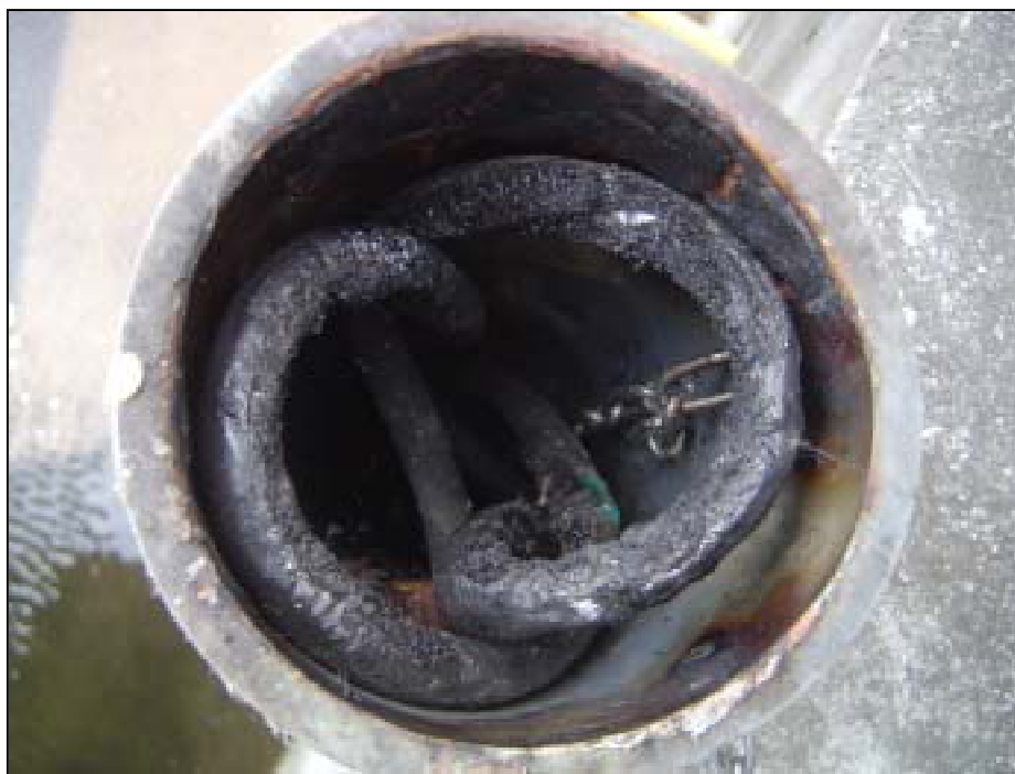
水位計の蓋を開けた状況:ケーブルに燃えた痕跡
