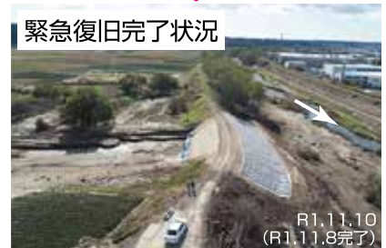
【郡山市】谷田川堤防決壊箇所
