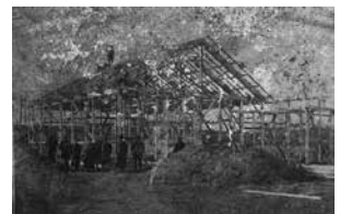
内務省当時の事務所新築状況(東北本線の捨場から石灰殻をトロ運搬によって埋立て、その上に荒川の瓦礫を表土として造成した。大正9年1月)
