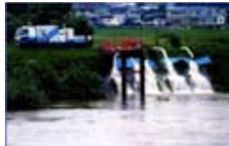
排水ポンプ車稼働状況
