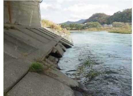
写真5-1 支川荒川 信夫橋護岸の崩壊の状況
