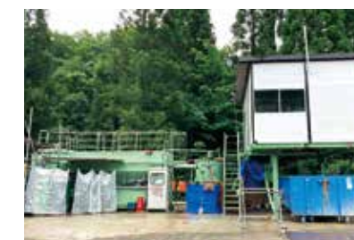
濁水処理設備
