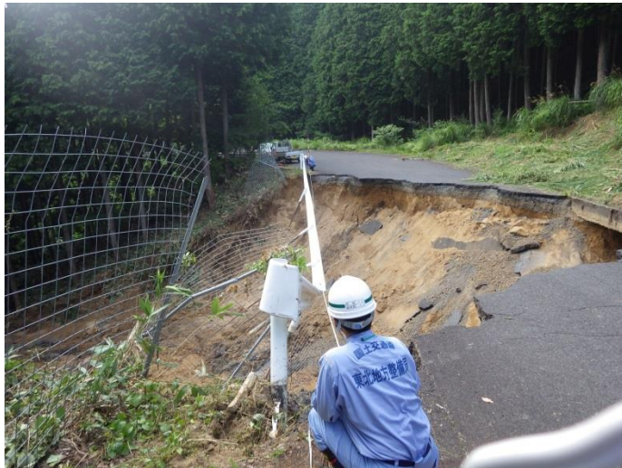
③被災状況の計測（H30.07.17 美作市）
