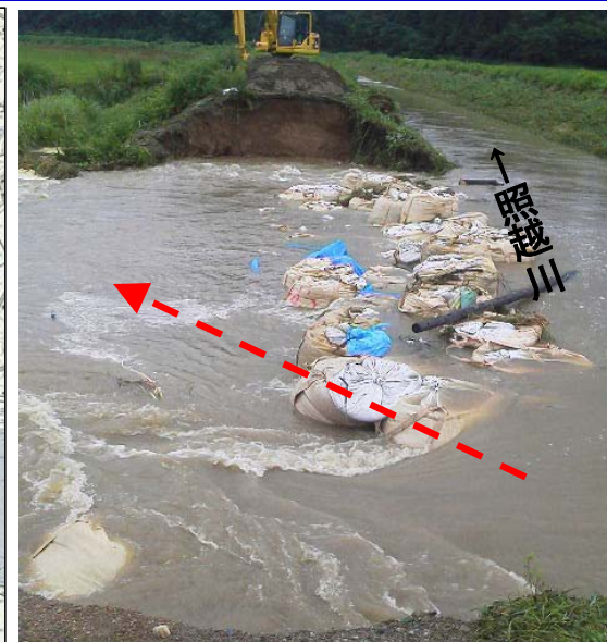
照越川左岸 (決壊状況) 7月27日18時頃
