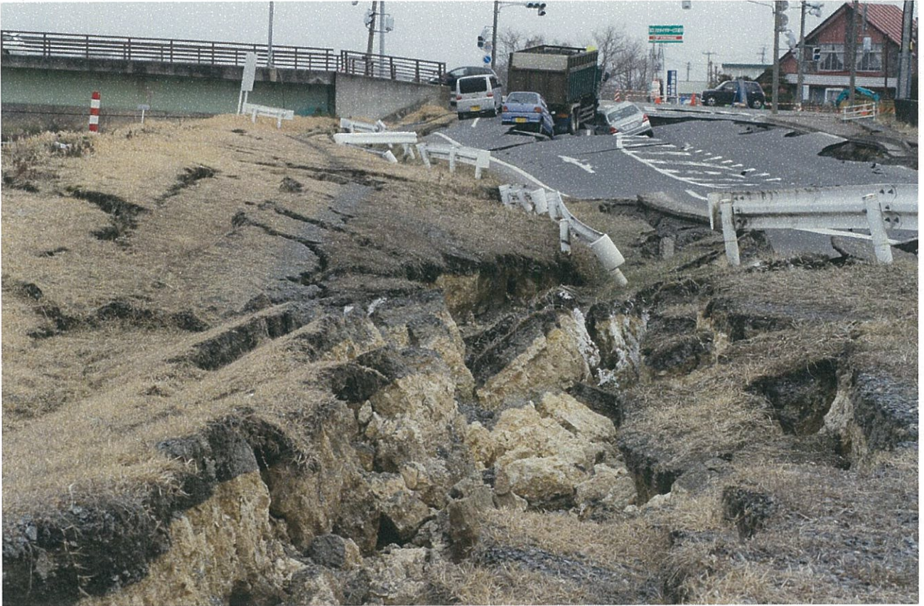
江合川左岸:大崎市瀧尻地区【堤防崩壊】
