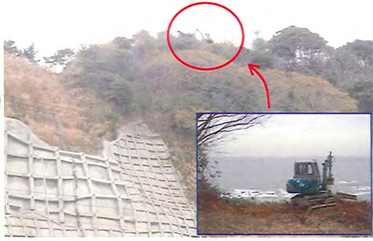
▲四倉法面亀裂対策(蟹洗温泉正面)
