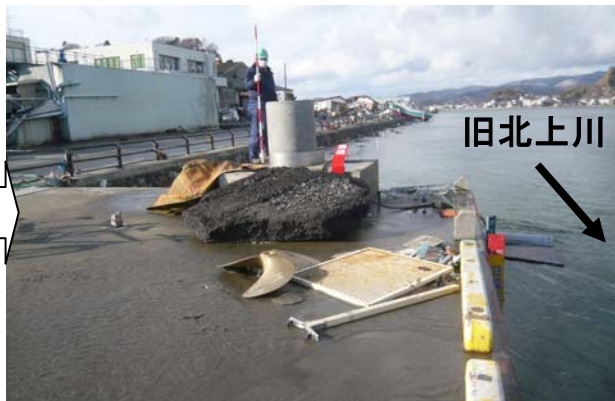
津波により流出した門脇水位観測所 (3月16日撮影)
