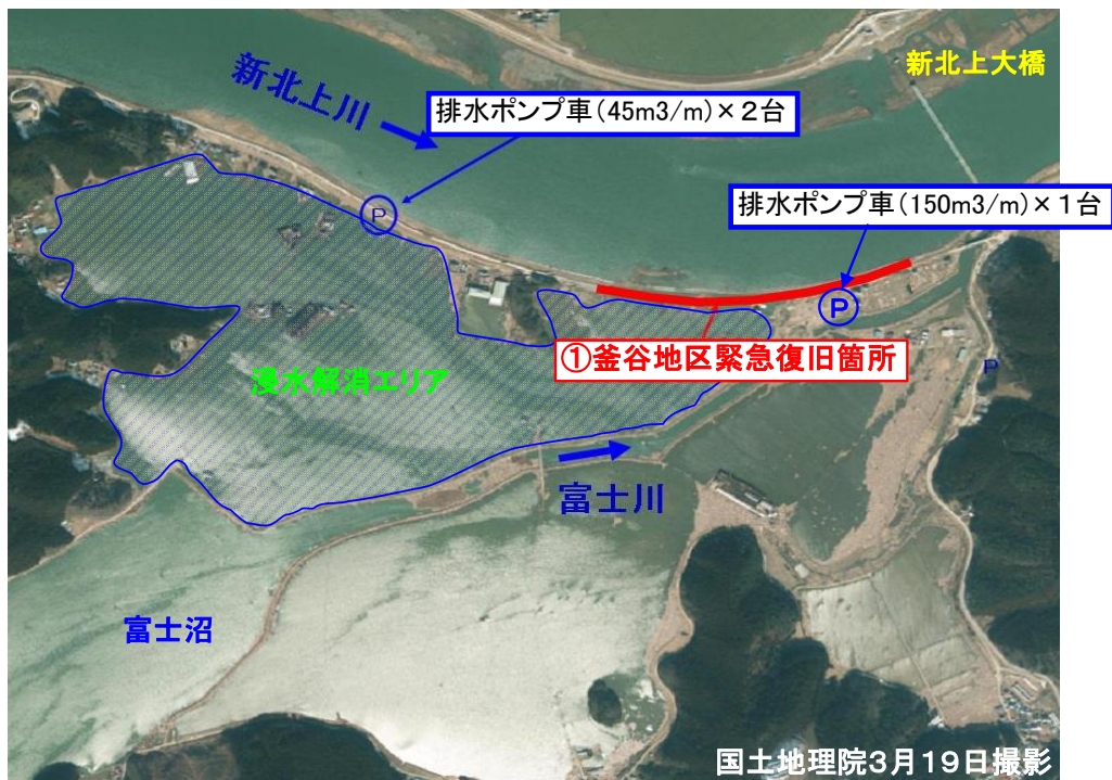
国土地理院3月19日撮影 浸水解消のため、北上川右岸5k付近に排水ポンプ車を設置し排水作業を実施。(石巻市針岡地先)
