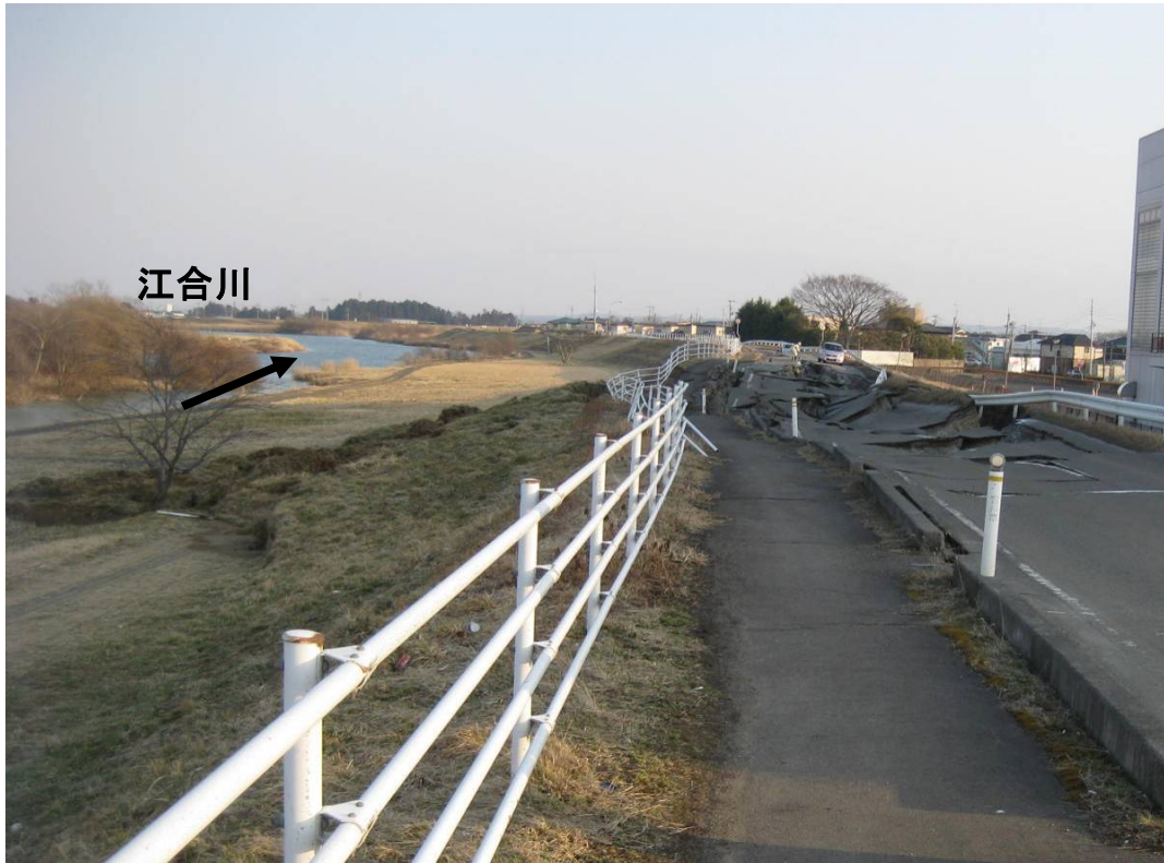
3月13日 堤防亀裂・沈下
