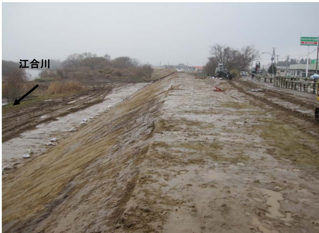
3月26日10時頃 堤防亀裂・沈下の復旧盛土完了 現在、コンクリートブロック張り作業中。3月31日目途に完了予定
