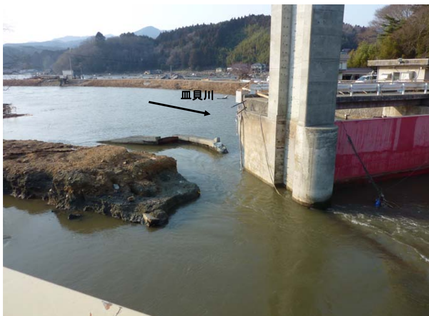
3月13日堤防被災状況 堤防決壊
