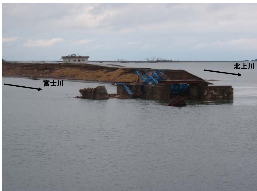
本体・ゲートともに損傷(水位が高く詳細調査不可能)
