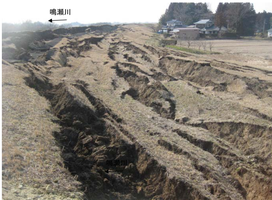
3月13日堤防被災状況 堤防沈下
