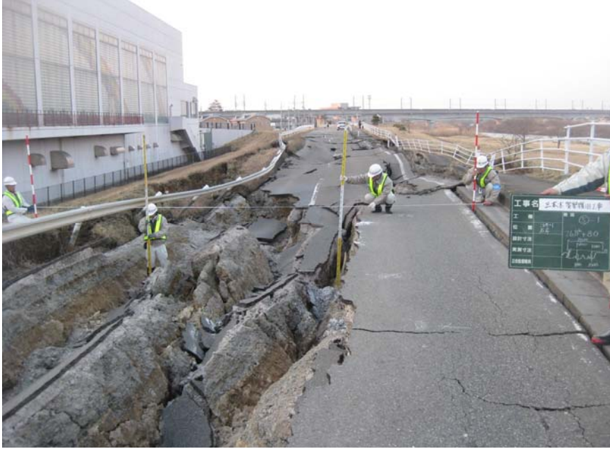
江合川右岸26.8k付近(堤防亀裂・沈下)
