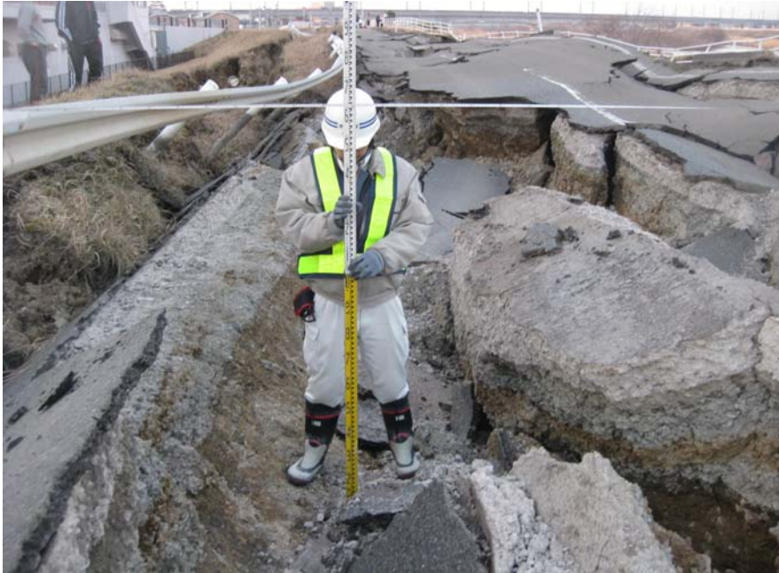
江合川右岸26.8k付近(拡大)(堤防亀裂・沈下)
