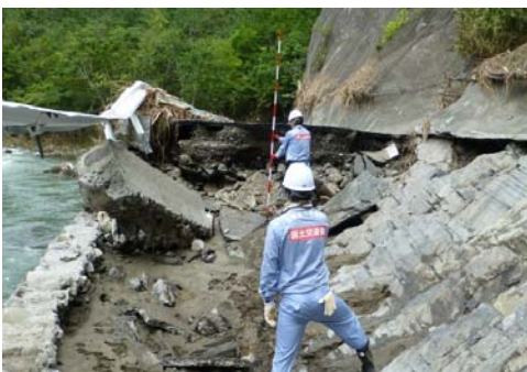
▲ 被災状況調査
