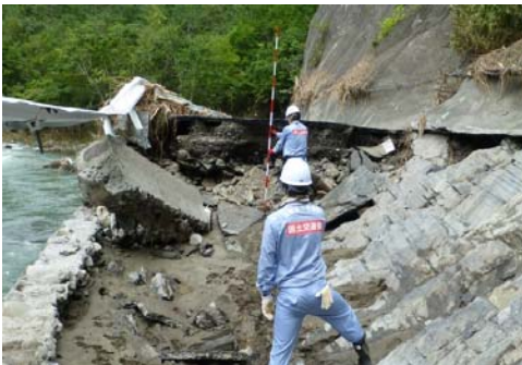
▲ 被災状況調査
