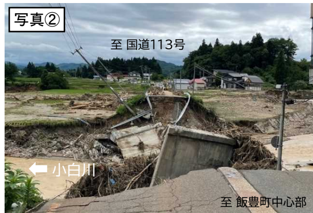
被災後の状況
