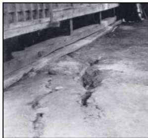
S33年頃 ひきまき 引牧の住居軒下の開口亀裂
