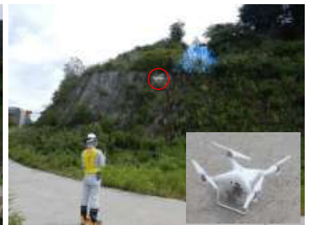
ドローンによる被災状況確認
