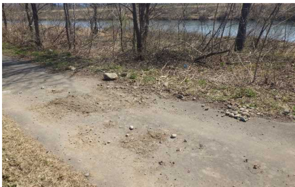
遊歩道上の汚損(砂利等)
