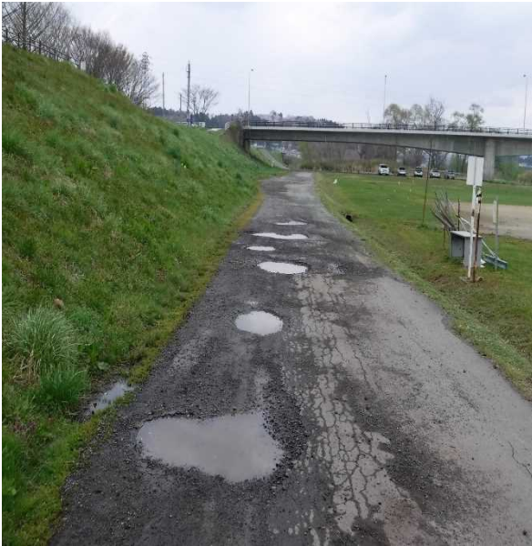
管理用通路舗装の損傷
