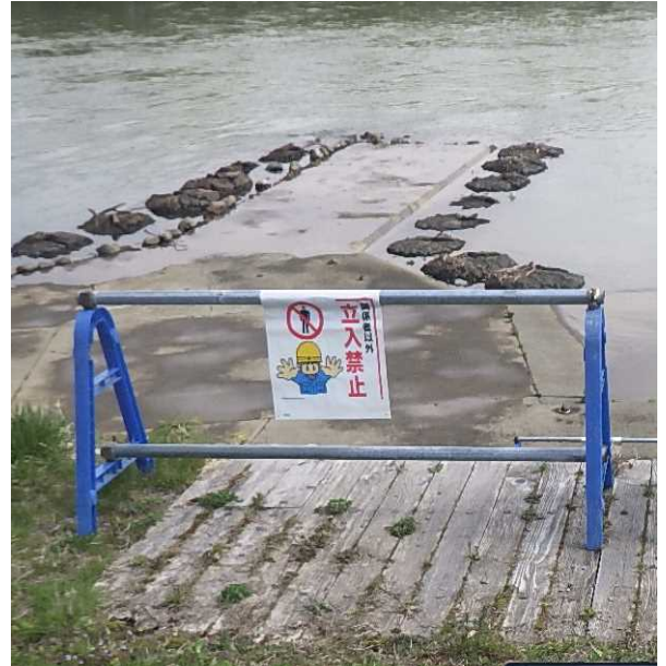
応急措置でバリケードを設置した。 復旧方法について検討中。
