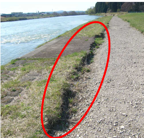
管理用通路(砂利道)の段差
