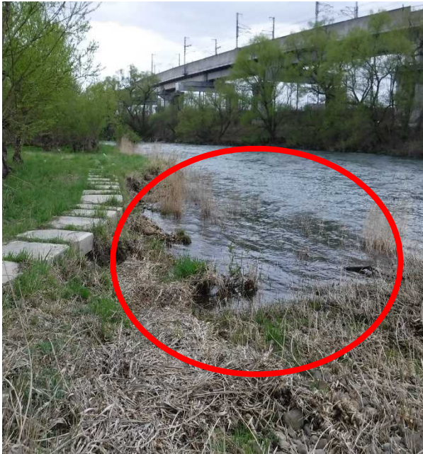
河岸散策路付近の河岸の洗掘
