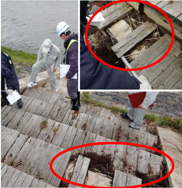
舟着場階段の踏み板の腐食
