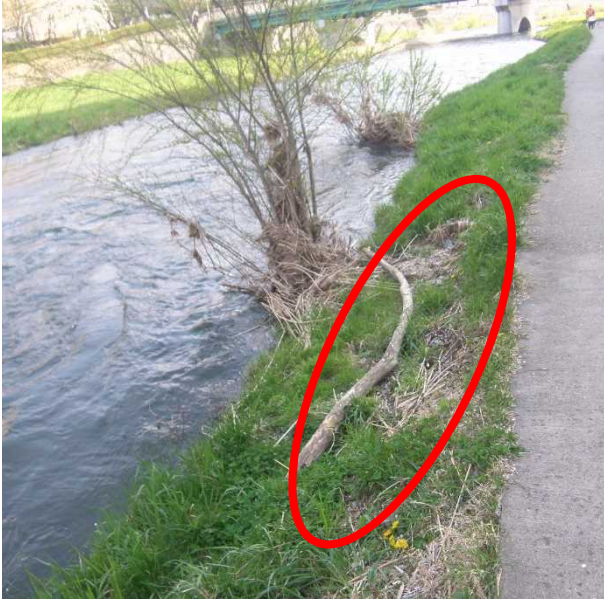
散策路の洗掘
