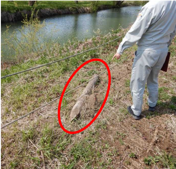
侵入防止柵の杭折れとロープの切断
