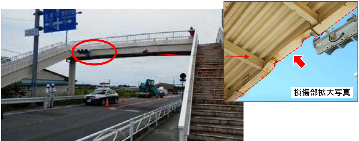
歩道橋 橋桁部の損傷状況（H26 年撮影）
