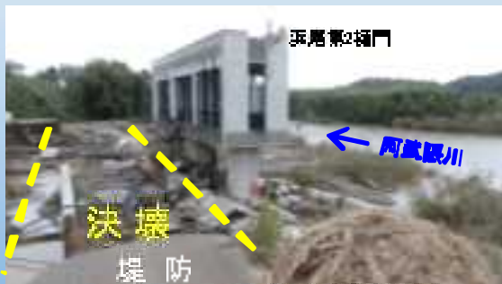
08.08 左岸堤防決壊箇所(須賀川市)
