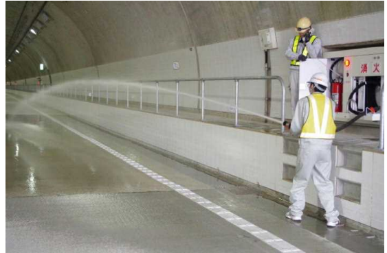
▲消火栓設備点検イメージ
