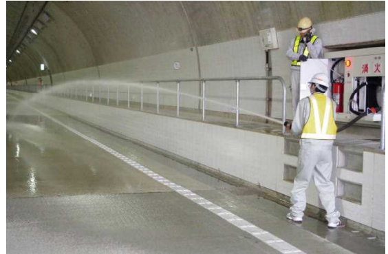
▲消火栓設備点検イメージ
