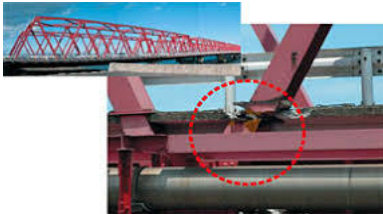
舗装損傷の例
