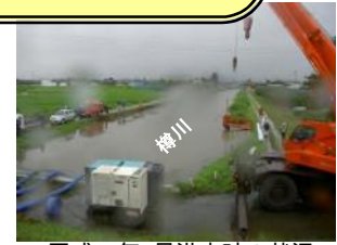
平成25年7月洪水時の状況
