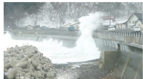
国道7号の越波状況
