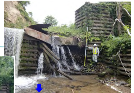
赤砂第1砂防堰堤損傷状況
