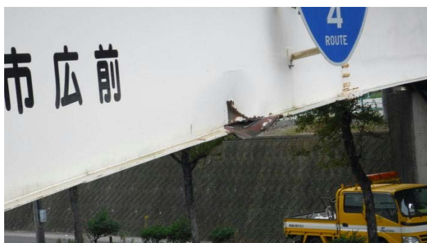
損傷箇所の拡大
