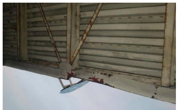
損傷箇所を下から見た様子
