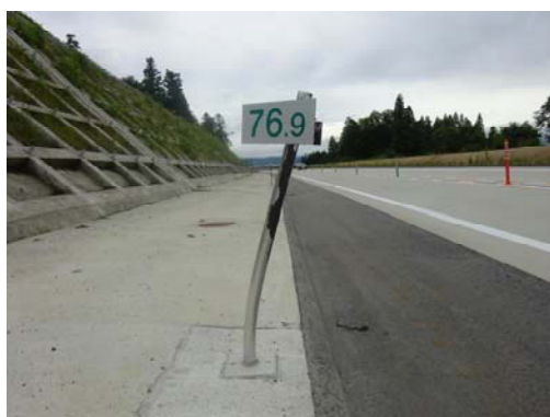
▲道路施設損傷イメージ
