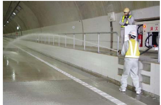
▲消火栓設備点検イメージ
