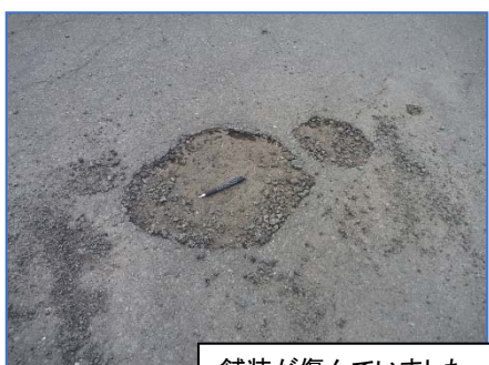
舗装が傷んでいました。
