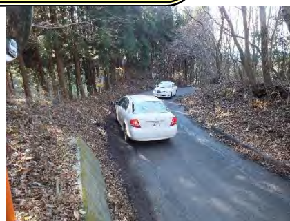
▲幅員狭小状況
