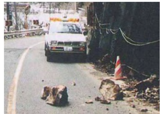
▲国道121号の落石状況
